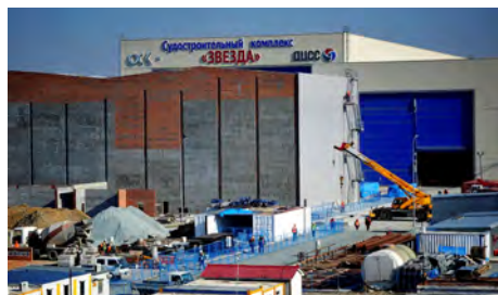
Судоремонтный комплекс "Звезда" Приморский край, г. Большой Камень Светильники серии LINE-ЕХ-Р
